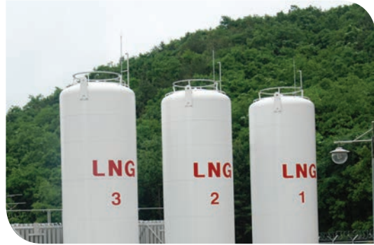
Daebu LNG Satellite Center
